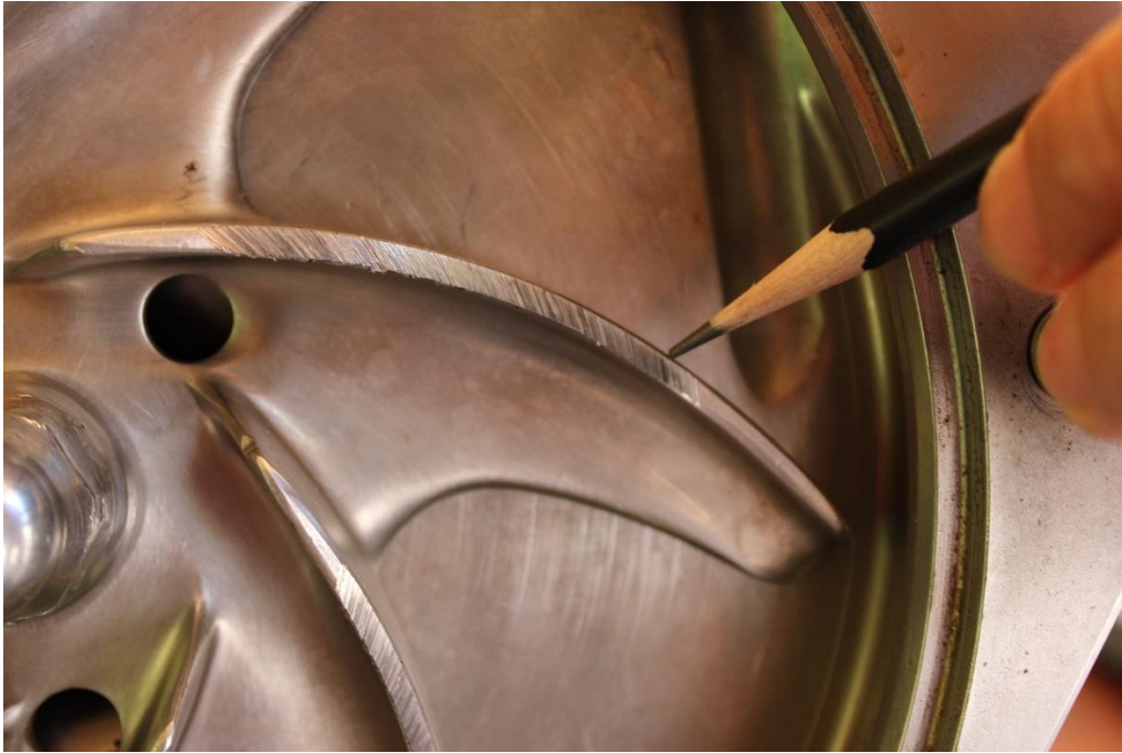
Figura 02: Desprendimiento de material severo en Impulsor
